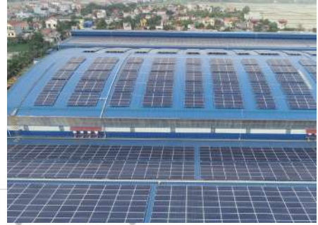
My Hao 1, 2 rooftop solar power plant Dự án Điện mặt trời áp mái Mỹ Hào 1, 2
