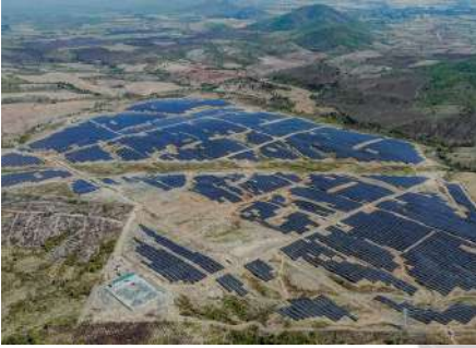
My Son 1, 2 solar power plant Dự án Điện mặt trời Mỹ Sơn 1, 2
