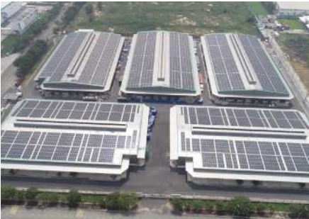
Rooftop solar power plant project at IP Vietnam Trading Service Corporation Dự án Điện mặt trời áp mái tại Công ty CP Thương Mại Dịch Vụ IP Việt Nam
